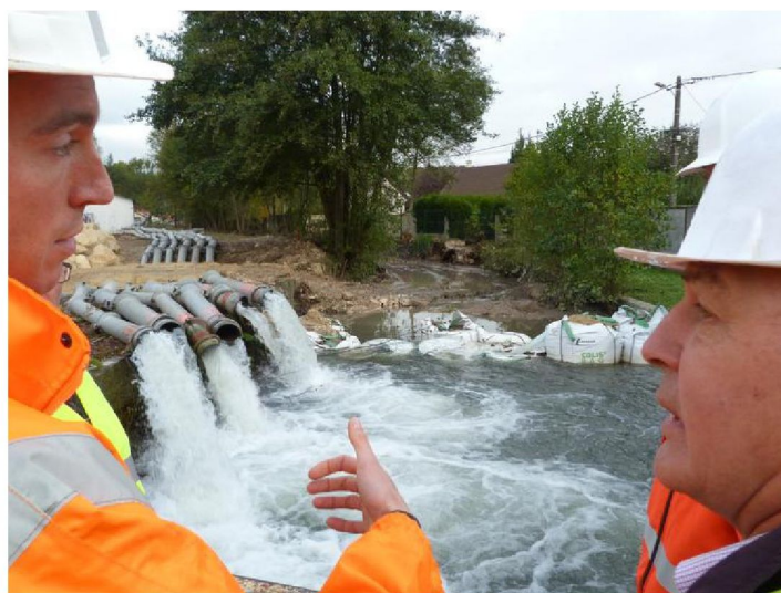
Erwan Le Corre, technicien rivière (à g.) et le maire de Litz, hier, devant l'exutoire des six canalisations déviant la Brèche à la hauteur de l'usine SAR.
